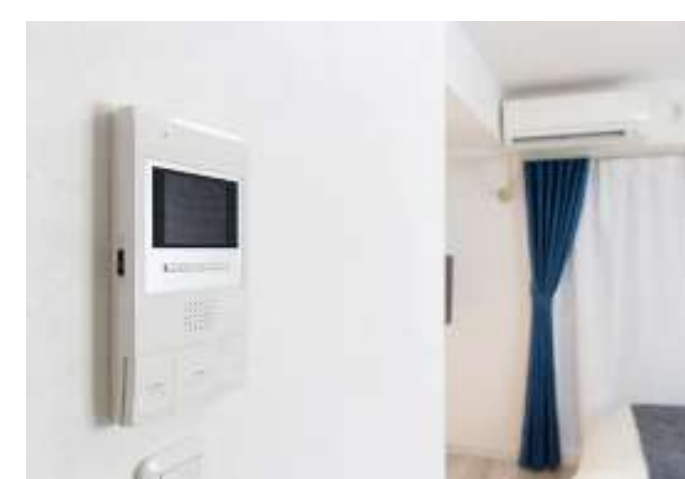
防犯防災設備
