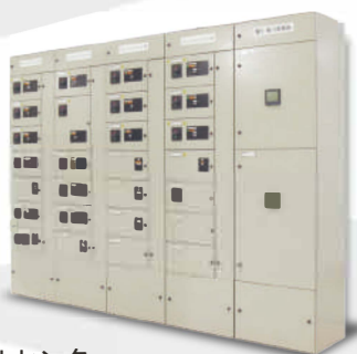
コントロールセンター
